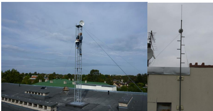
5.10. att. 5GHz “bridge”, kuru izmanto, lai radītu Smart bāzes tīklu.
