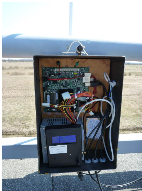
5.18.att. Viena no pirmajām vārtejas versijām (uzstādīta uz pansionāta “Selga” jumtas)
