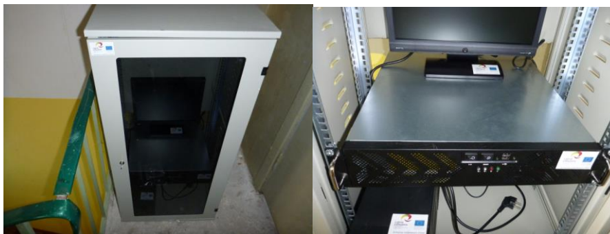
5.23.att. Smart Meter sistēmas serveris, kas tika izvietots pansionāta "Selga" ēkā
