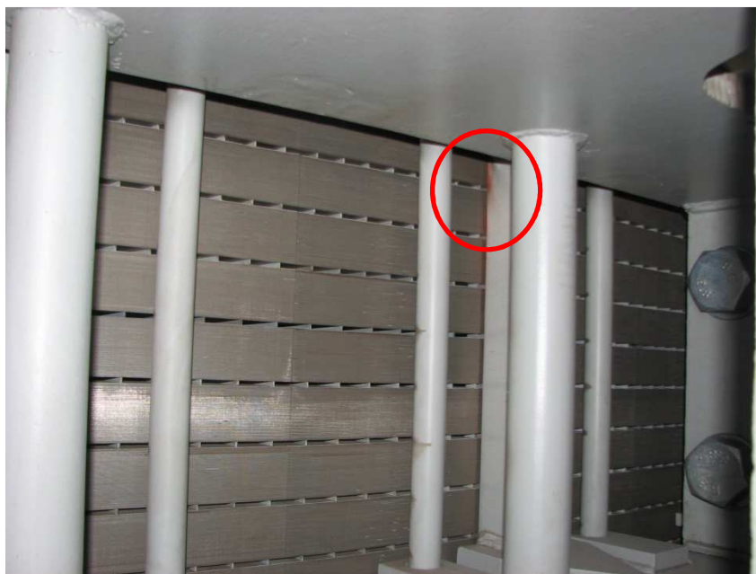
1.3. att. Korozija uz pirmā objekta statora serdes elementiem
