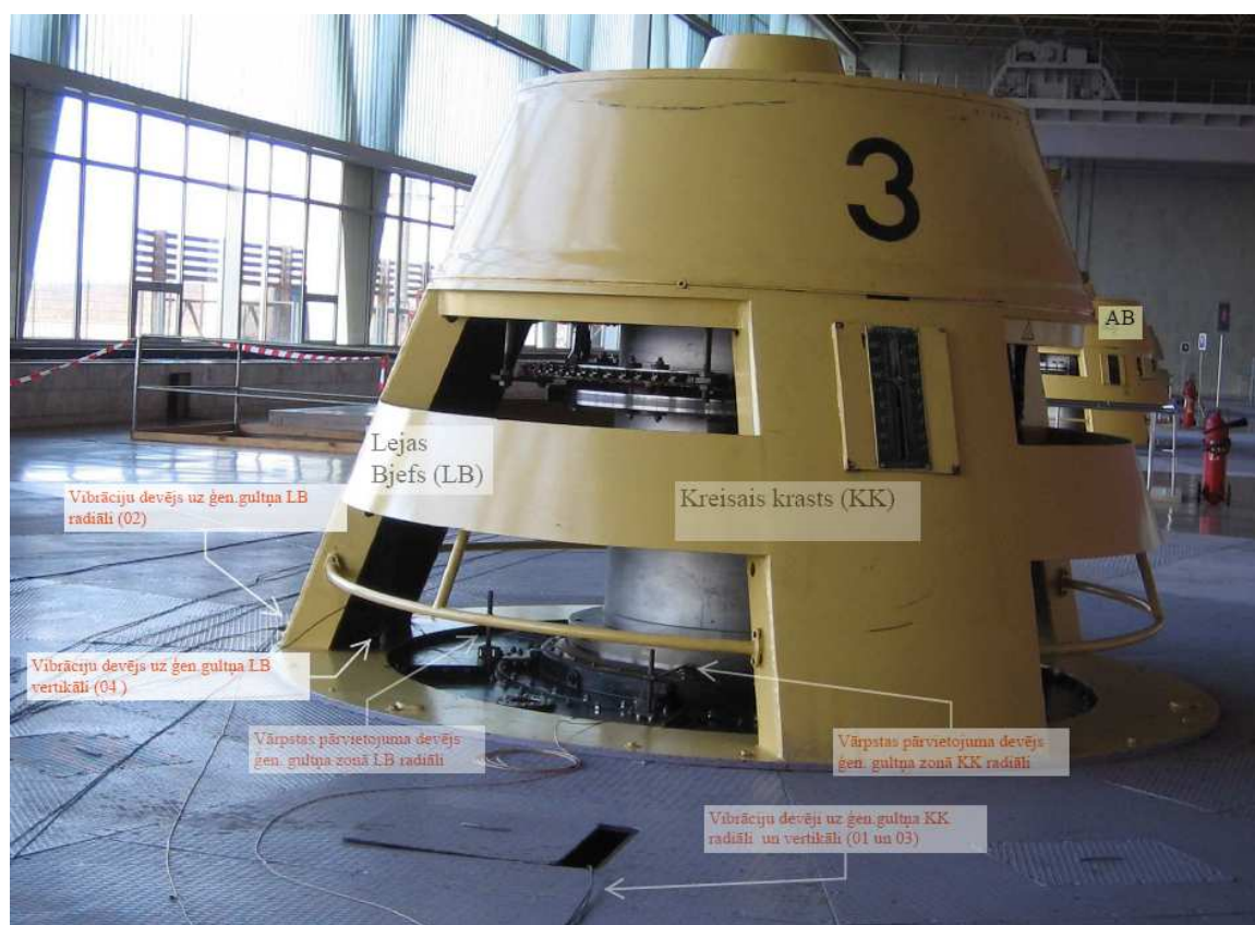
6.2. att. Otrā objekta mērījumu vietas uz ģeneratora gultņa
