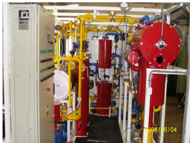
1. Att. Eļļas reģenerācijas stacionāra iekārta.
