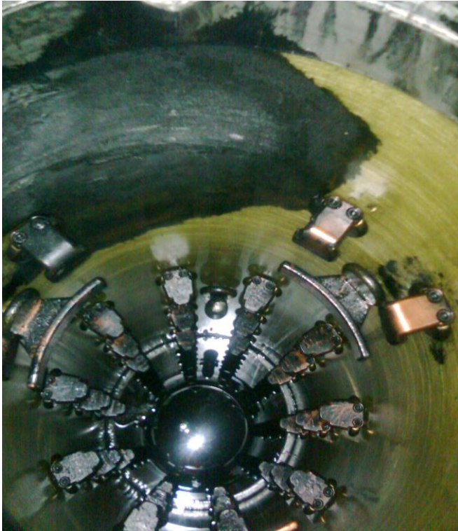
6. att. Pārslēdzošās ierīces (kontakta) defektēta tvertne
