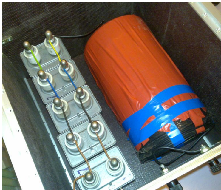
4.2.att. Pētāmās droseles-kondensatoru bloka attēls
