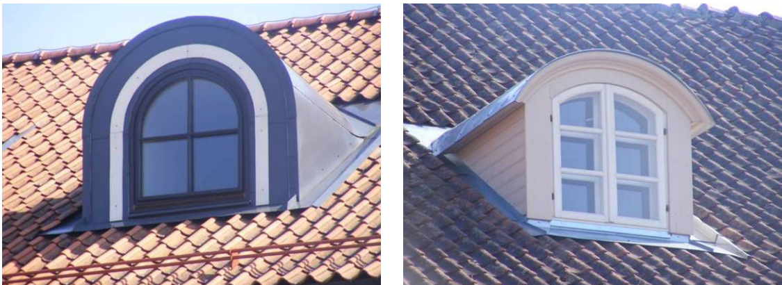
3.2.1.. un 3.2.2. att. Pa kreisi – vēsturiskajai videi neatbilstoša jumta izbūve, pa labi – videi atbilstoša izbūve
