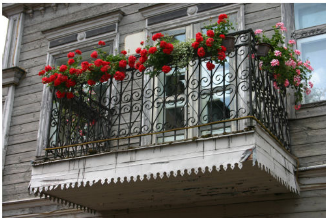
1905_gada_1_62010060039001_balkons1 Vēsturiskas balkona margas, pamatne – 20.gs.2.puse.
