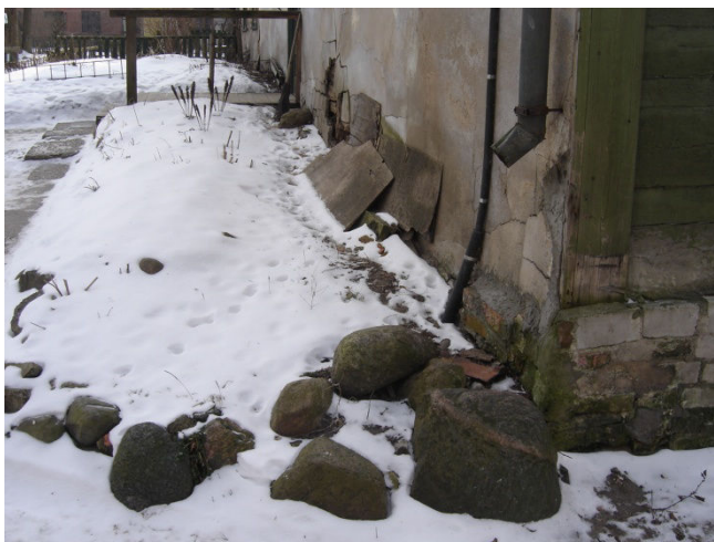
1. att. Pārāk augstu izvietotas notekcaurules un puķudobes pie ēkas pamatiem bojā tos
