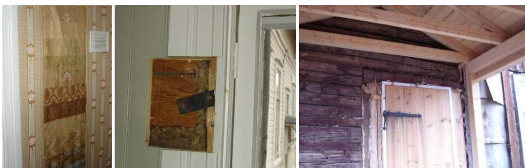
2.1.1.3. līdz 2.1.1.5. att. Vēsturiskās ēkas tapešu slāņi. Tammel restaurācijas darbnīca. Ēkas piebūve, kurā tiek iebūvētas jaunas durvis, bet izmantoti vēsturiskie metāla kalumi
