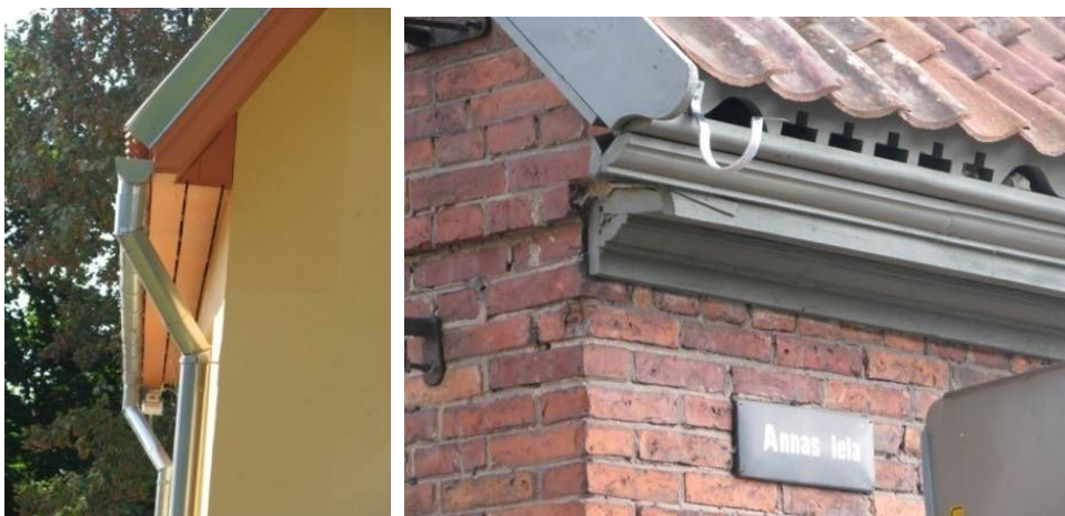
3.2.4. un 3.2.5. att. Pa kreisi – siltināta ēka, kurai raksturīgās dzegas vietā ierīkota „vēja kaste”, pa labi – Kuldīgas vecpilsētai raksturīga dzega ar robdēli.
