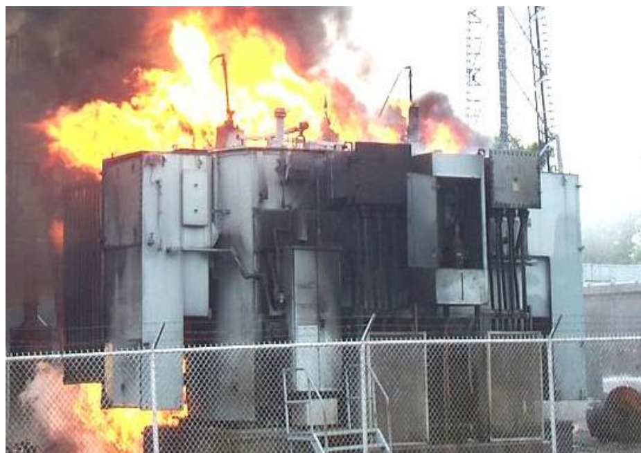
1.2. att. Lieljaudas transformatoru degšana
