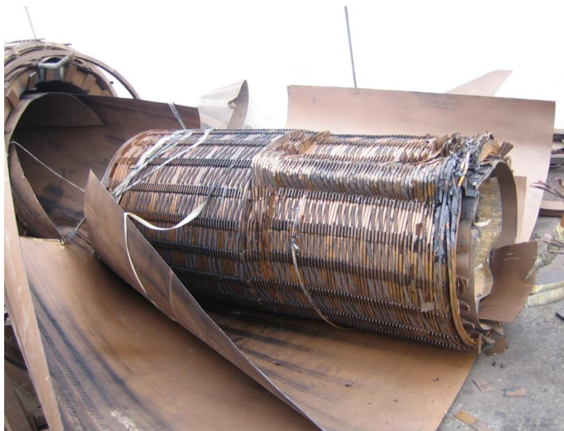
1.9. att. Transformatora tinumu deformācija
