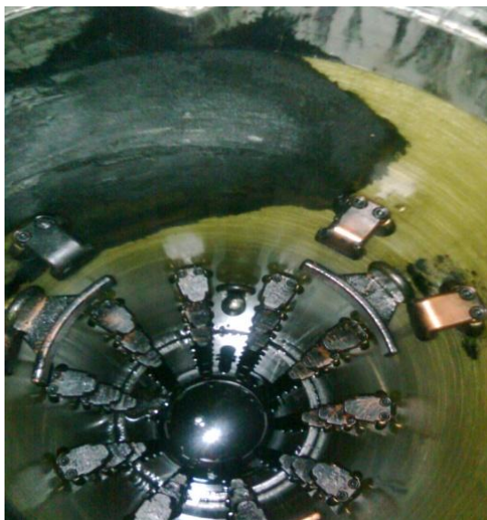
1.10. att. Pārslēdzošās ierīces (kontaktora) defektēta tvertne
