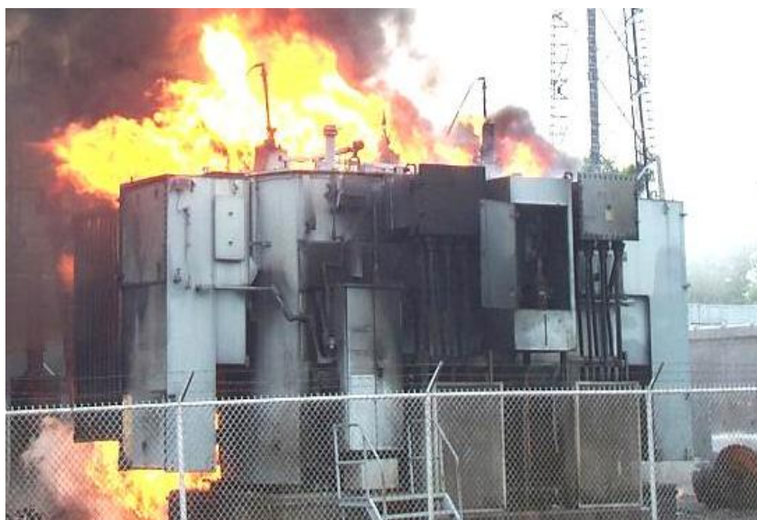
1.1. att. Lieljaudas transformatoru degšana
