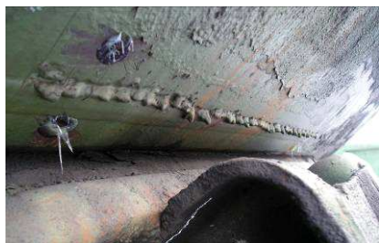
2. attēls. Sānu un apakšējo katla lokšņu metinājumu šuvju zona virs nekustīgajiem balstiem
